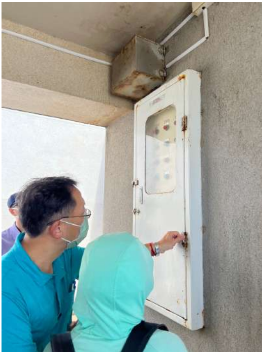
6S 實地範例解說，勘查戶外電箱鎖頭裝置
