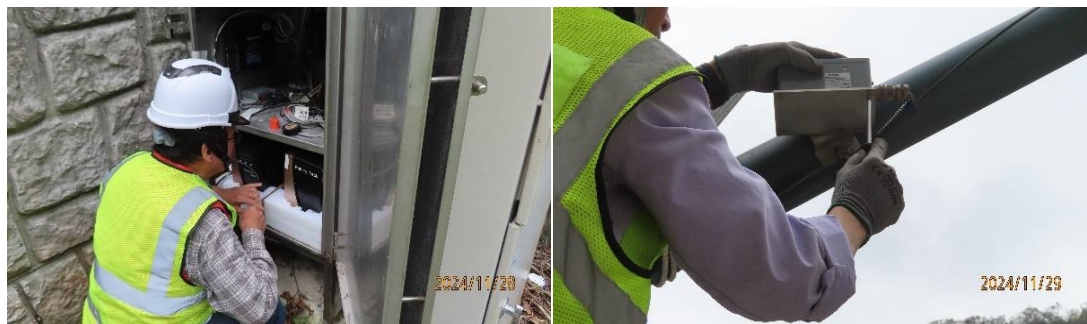
圖9 不斷電系統(UPS)更新與索力計更新
