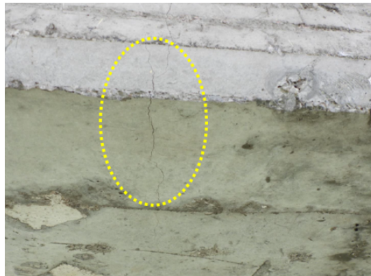
圖 8 石灼高架橋 PE4-PE5 箱型梁撓曲裂縫之目視檢測
